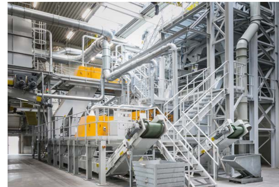
© Valerie Clarysse - Deceuninck investeert al jaren in duurzaamheid en circulair bouwen dankzij de recyclagefabriek in Diksmuide
