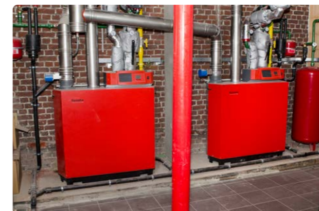
stookplaats met de verwarmingsketels
