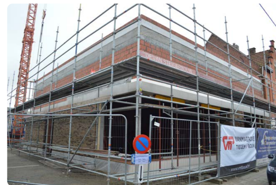
De bouw van de sporthal startte in juni 2020 en moet eind mei 2021 af zijn.
